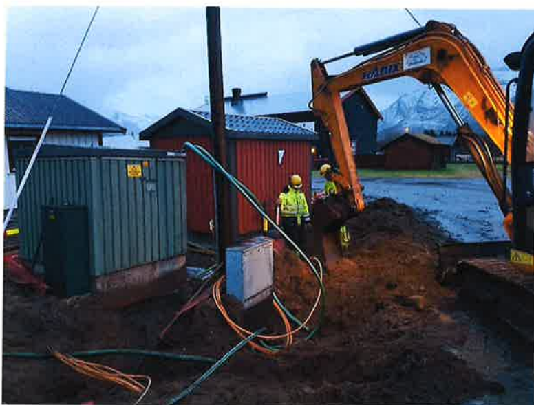
Skifte til større trafokiosk Reipå Industri.
