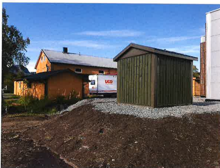
Ny trafokiosk Enga 6 (Coop Engavågen).
