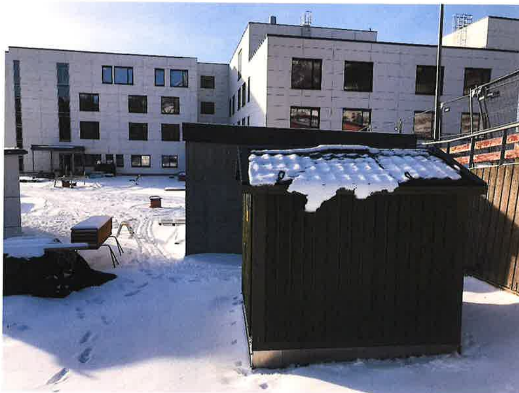
Ny trafokiosk Mosvold 7.
