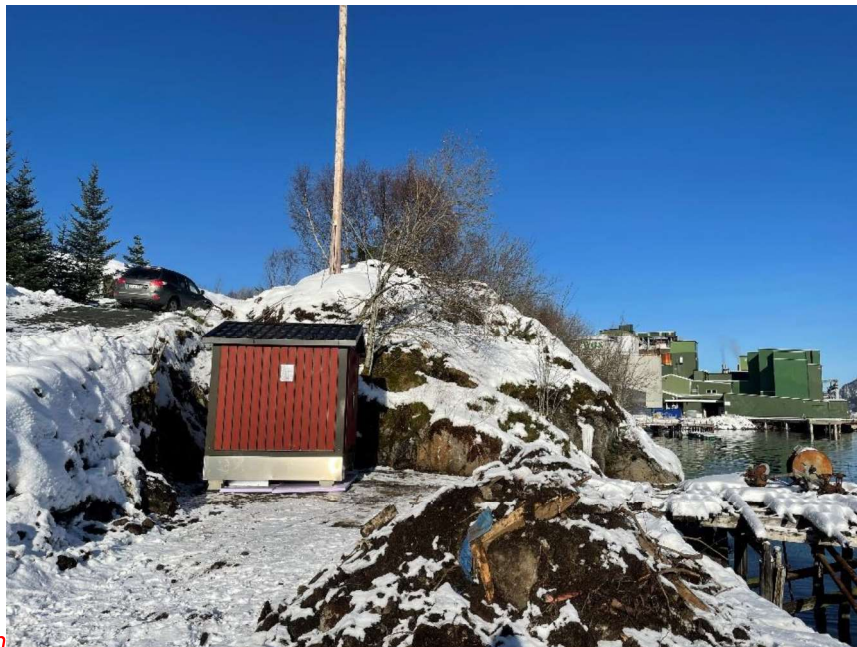
Forøy 3. Ny Siemens nettstasjon med 315kVA trafo er satt i drift.
