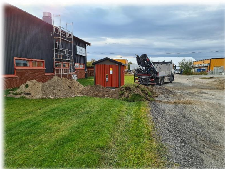
Ny trafokiosk Reipå industri 2 i forbindelse med etablering av vaskeri
