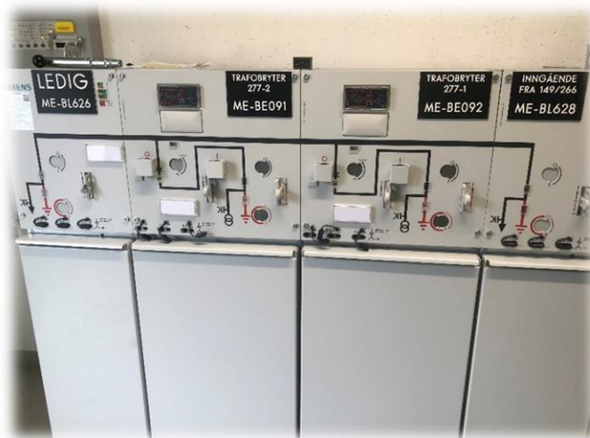
Nytt koblingsanlegg og trafo i forbindelse med idriftsettelse av ny el.kjele på Cargill
